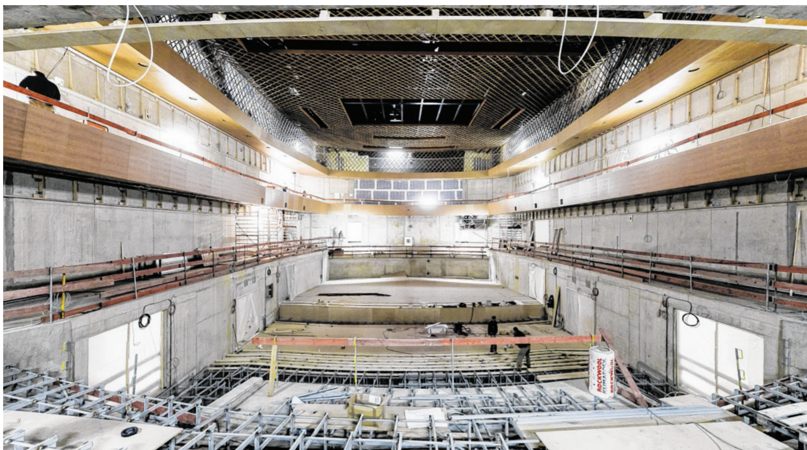
So sieht aktuell der Konzertsaal aus. Im Hintergrund die Bühne, vorn die Unterkonstruktion für die Publikumsitze. Im Juni 2016 soll alles fertig sein. FOTOS: INGO OTTO
